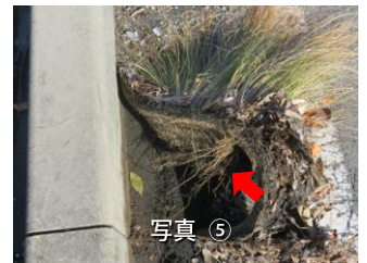
・路上から地下へ根の伸長
