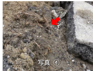
・舗装下路盤内部の宿根
